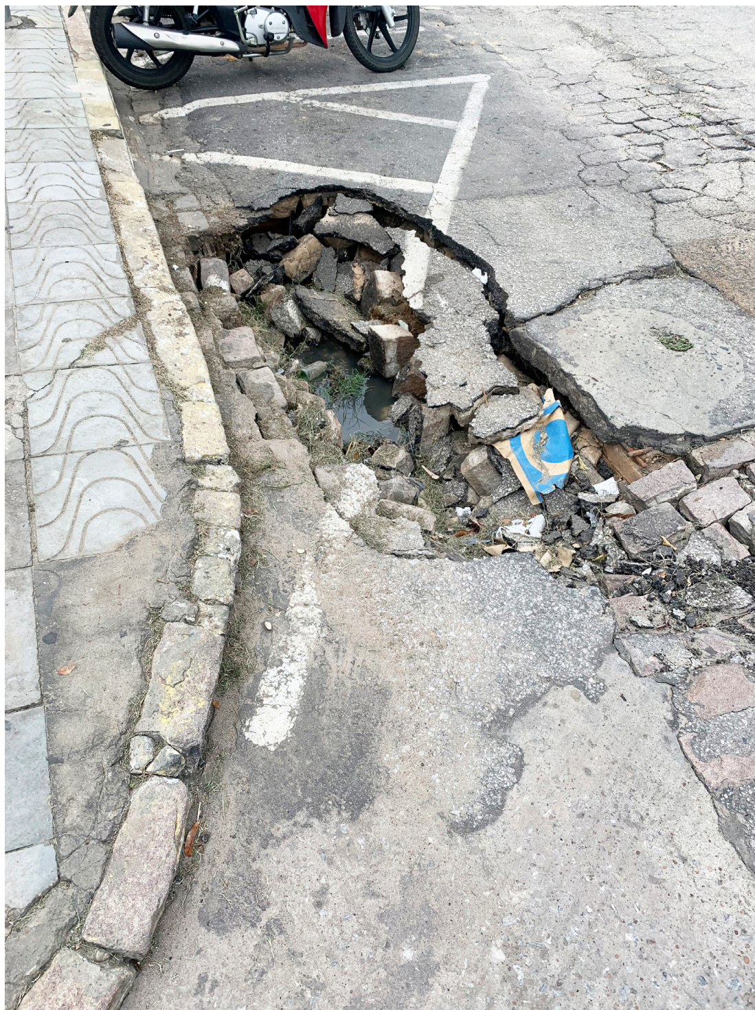
► R. Ariston de Souza Meira, Centro.
