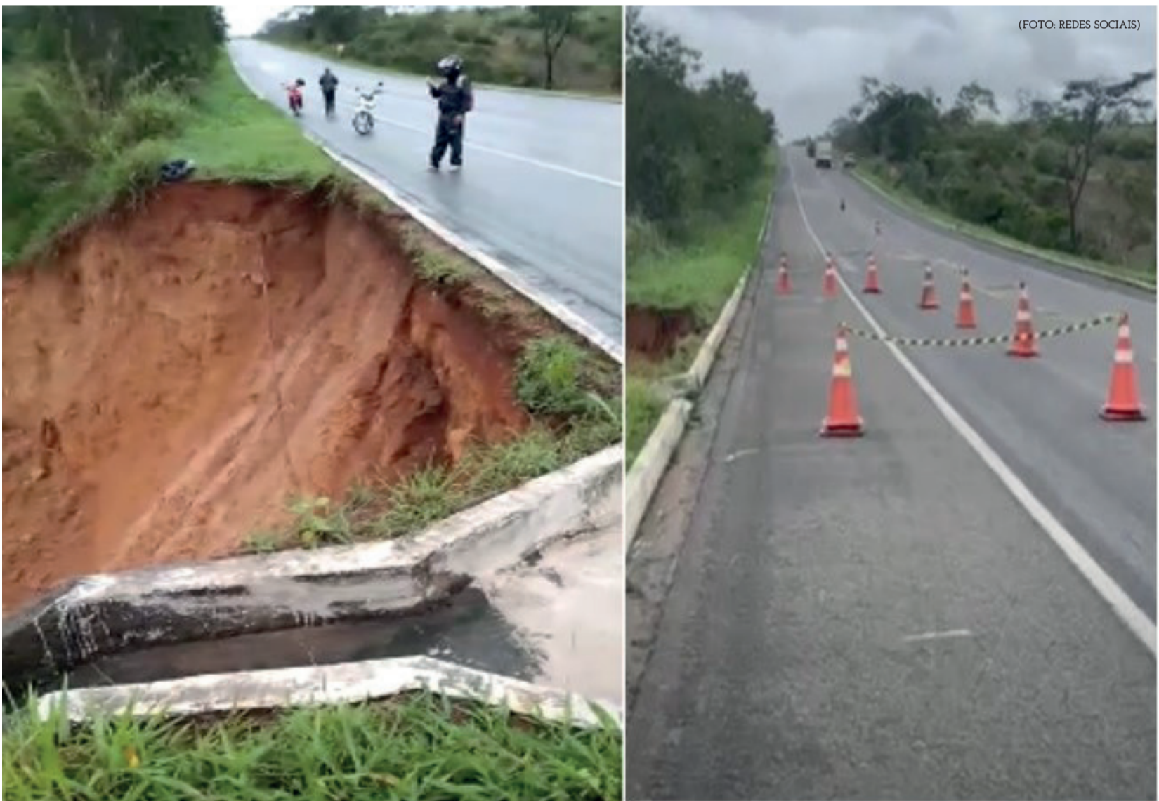
Trecho da BA-263, entre Vitória da Conquista e Itambé, está parcialmente interditado.
