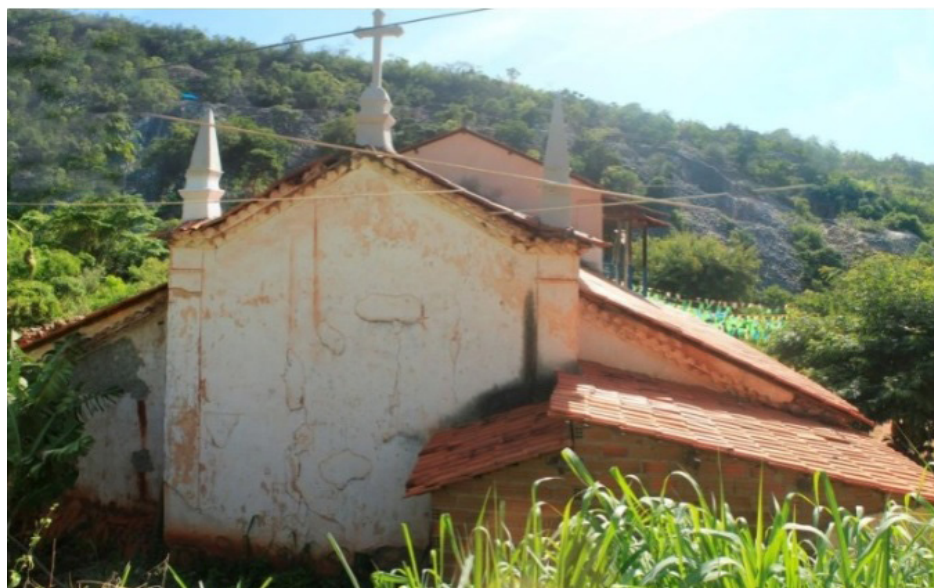
Fachada posterior da Capela Nossa Senhora do Carmo com danos e volume anexo atrás da sacristia
